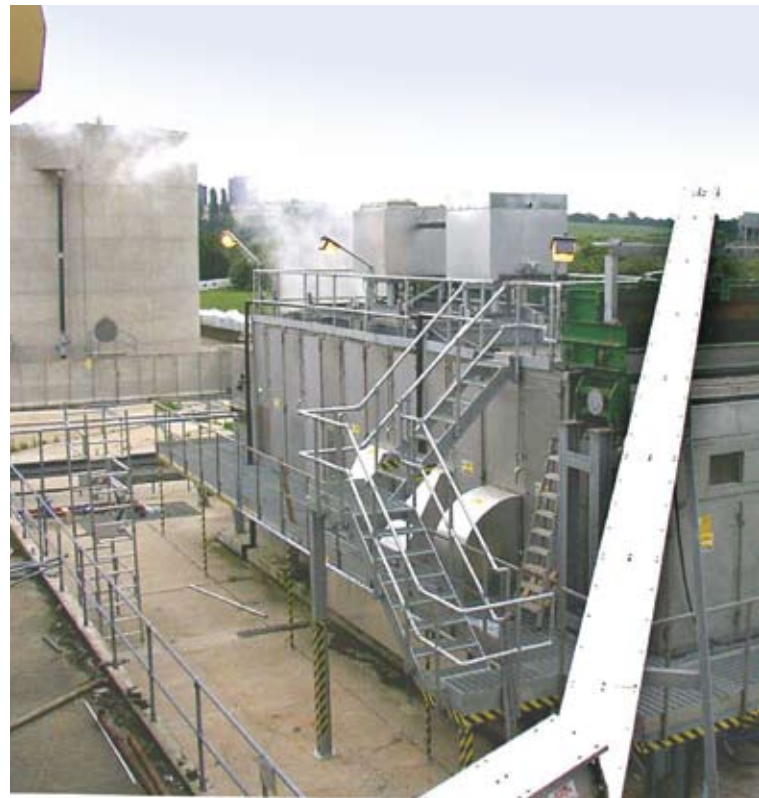
Installation de séchage SEVAR avec
